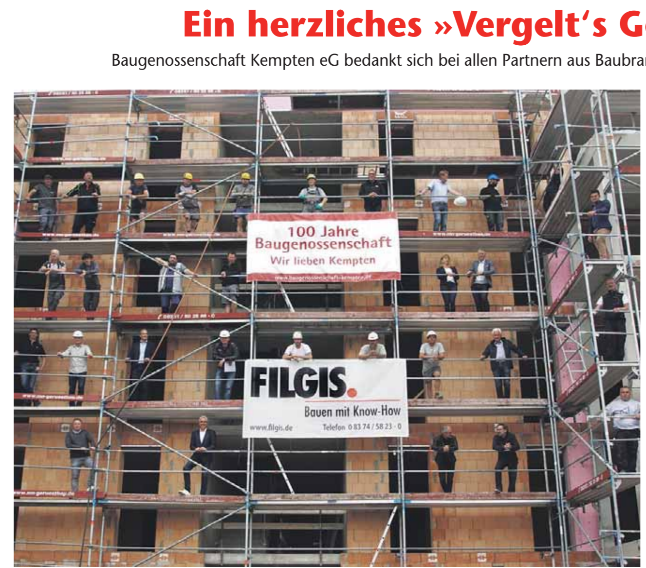
Derzeit errichtet die Baugenossenschaft in der Memminger Straße, Ecke Floßberg, einen Wohnkomplex mit 29 Wohneinheiten.
