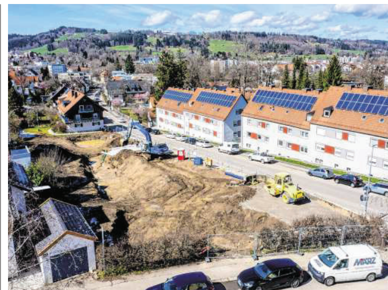
16 Einheiten der insgesamt 21 Wohnungen sind mit dem sogenannten „Wohnbaubooster“ Bayerns gefördert. Fotos: Ralf Lienert
