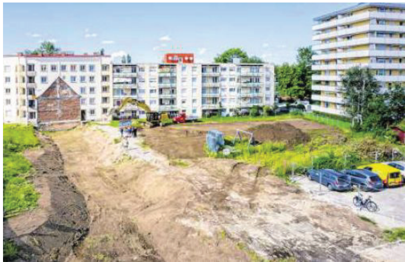
Am Floßerweg entstehen 29 familien- und behindertengerechte Wohnungen. Die Baugenossenschaft Kempten investiert neun Millionen Euro. Foto: Ralf Lienert
